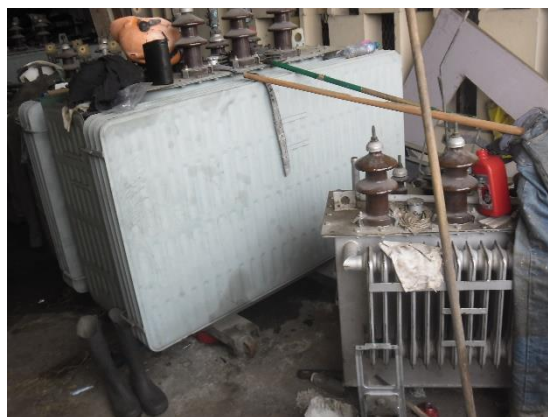
Figure 2: Ecoulement de PCB au sol
