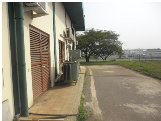
Figure 3: Transformateur PCB stocké sur une allée
